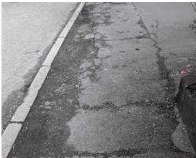
Gehweg Schäden "Hinter Lehen"
